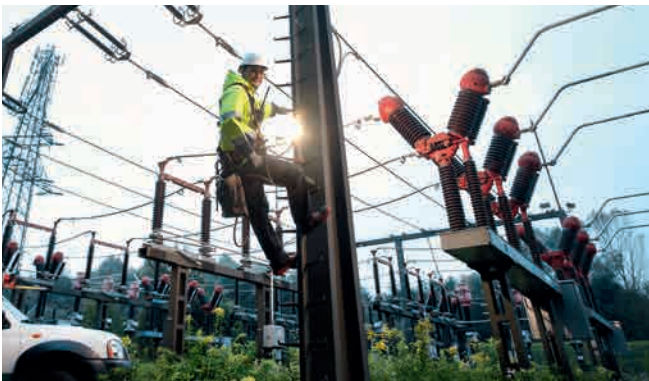
Die MitarbeiterInnen der LINZ NETZ GmbH garantieren eine sichere Stromversorgung rund um die Uhr.
